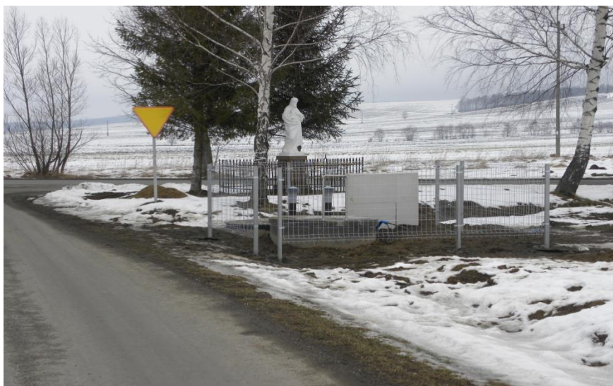
Jedna z przepompowni ścieków
