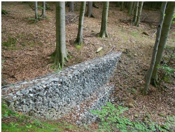
Obr. 14 drôtokamenný kôš (detailný záber)
