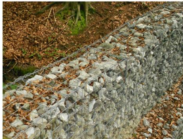
Obr. 15 drôtokamenný kôš (detailný záber)
