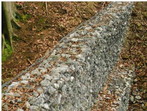
Obr. 13 drôtokamenný kôš (detailný záber)
