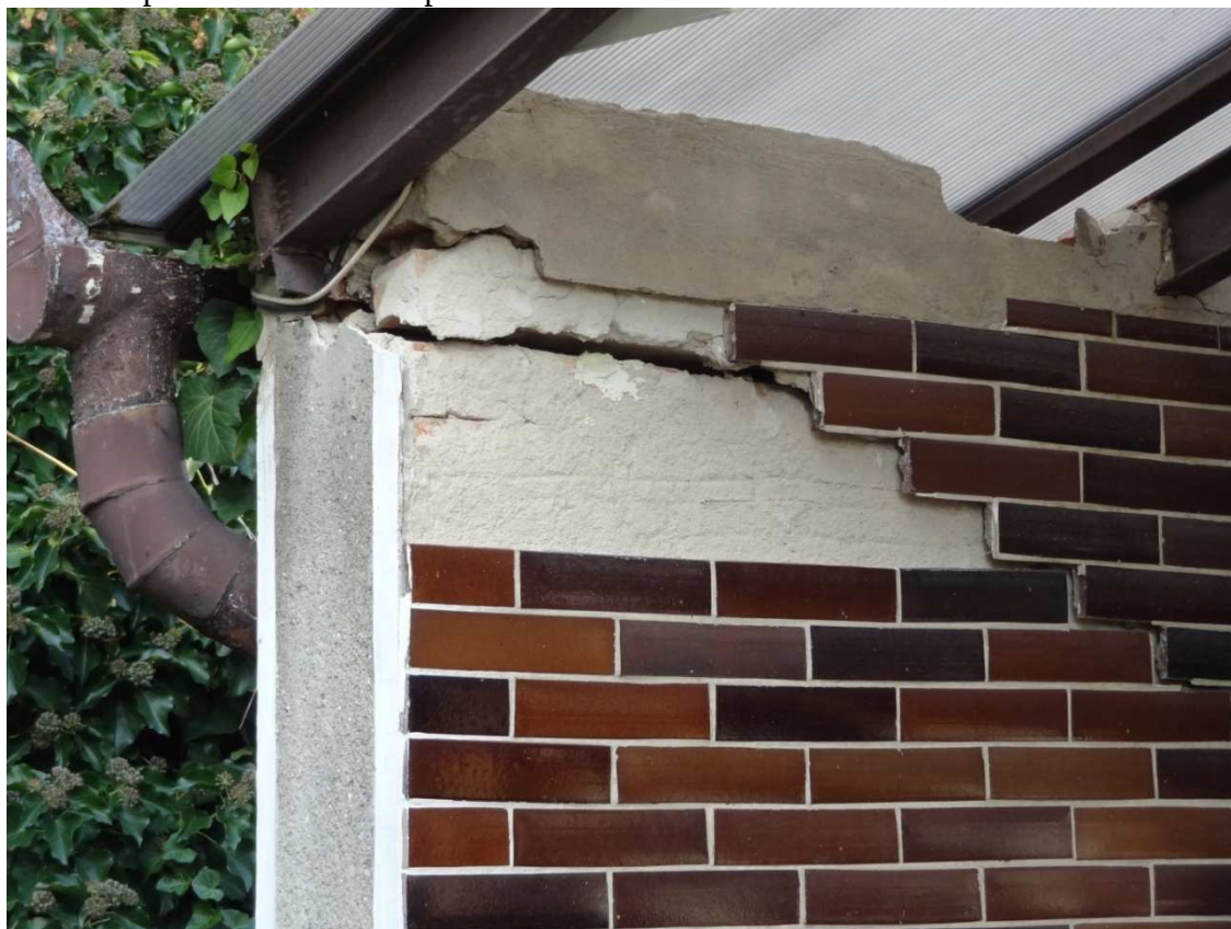
obr. č. 12 Poškodenie vonkajšieho múru
