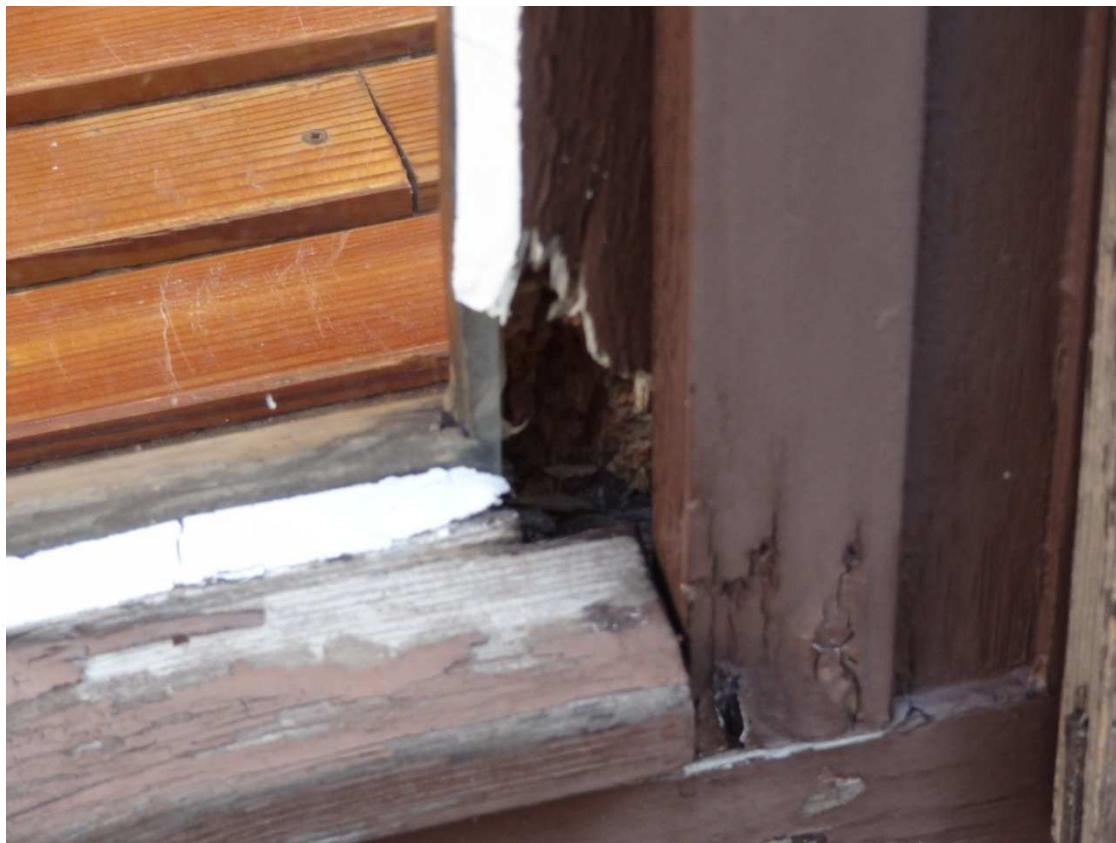
obr. č. 11 poškodenie okien – pohľad zvonku
