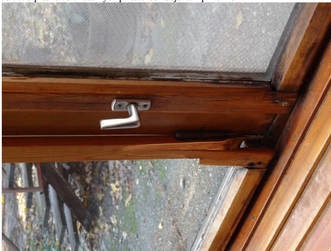
obr. č. 10 poškodenie okien v spodnej časti – pohľad z vnútra
