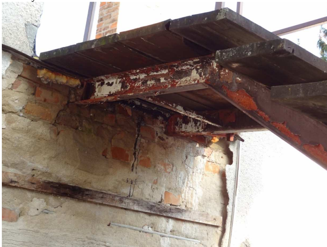
obr. č. 7 Poškodenie múru pod terasou
