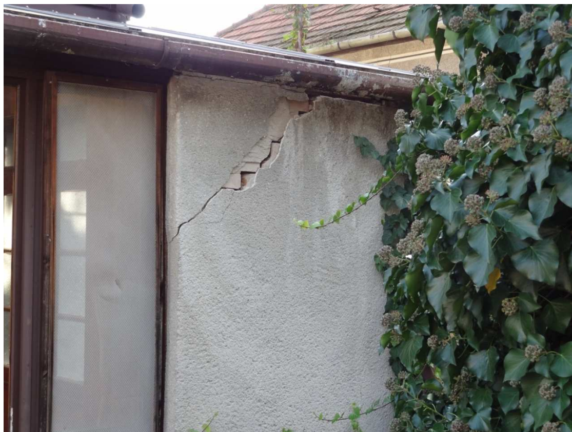
obr. č. 13 Poškodenie vonkajšieho múru v spodnej obytnej časti
